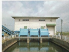
①取水源となる舞潟揚水機場
